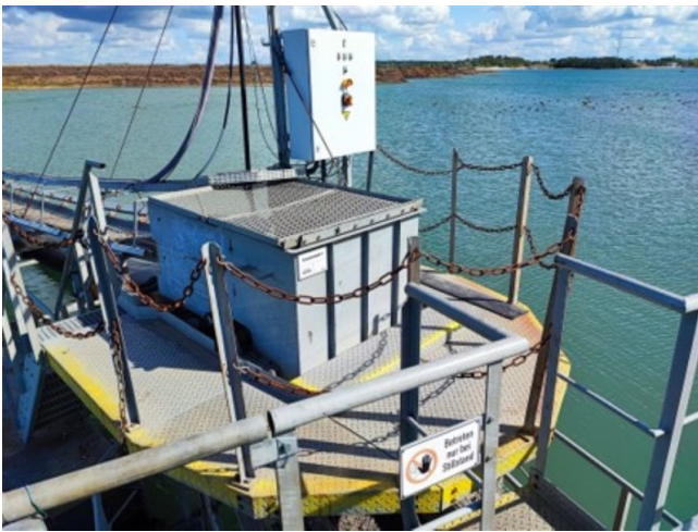
Ketten umlaufend als Absturzsicherung an Übergängen
