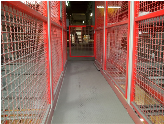
Zugangstür Sicherheitsbereich mit elektr. Zuhaltung
